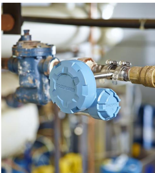
Figura 3. Um transmissor acústico montado próximo ao purgador na tubulação, de modo que nenhuma parada seja necessária.
